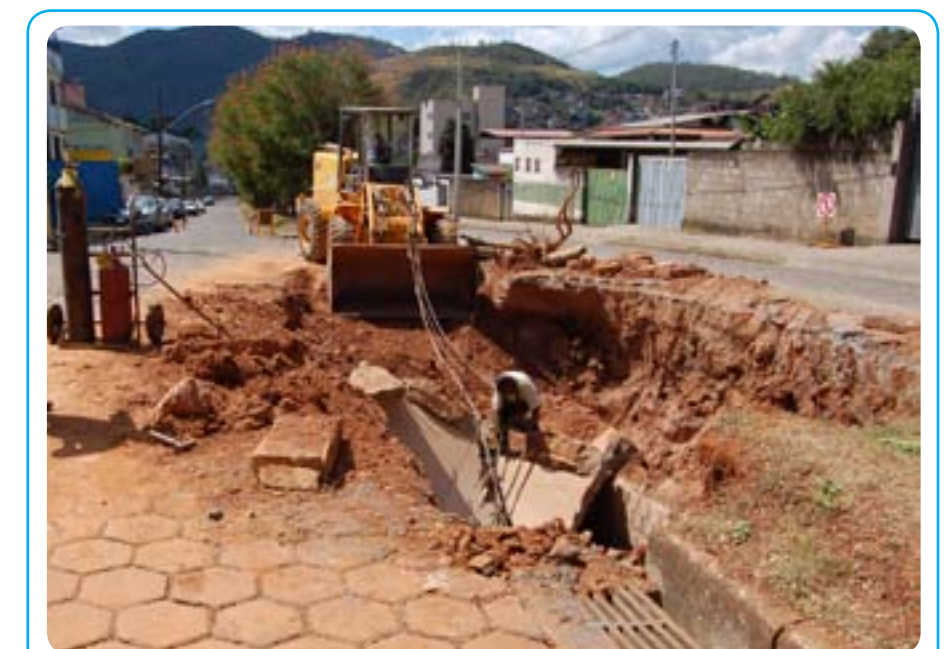
Funcionários da secretaria de Obras realizam reparo na rede pluvial danificada pelas chuvas na avenida Rodrigues Alves, no bairro República. A via e o canteiro central serão revitalizados e o trânsito será normalizado nos próximos dias.
